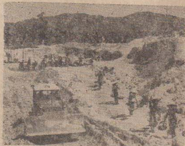
Sức người phối hợp với cơ giới thi công xây dựng đập nước Sô-hầu, Đức-phò, Nghệ-bình.
