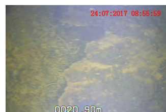
Hình 4. Vết nứt tại độ sâu 20,90 m [2].
