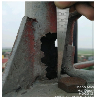
Cột ăng-ten xây dựng từ năm 2006 bị vỡ ống tại Thanh Miện - Hải Dương.
