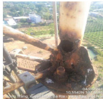
Cột ăng-ten xây dựng năm 2009 tại Bông Trang, Xuyên Mộc, Bà Rịa - Vũng Tàu.
