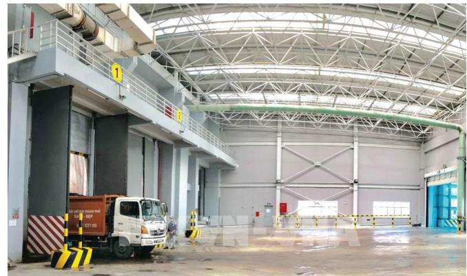
Nhà máy đốt rác phát điện Cần Thơ, một trong những nơi tạo ra lượng tro xỉ lớn trong cả nước.
