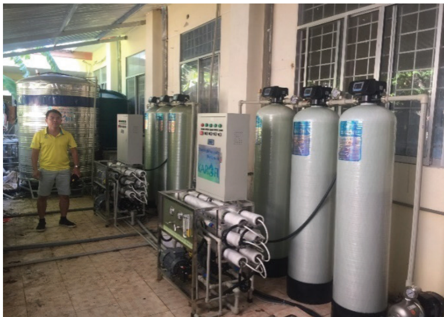
Hệ thống lọc nước Karofi tại xã đảo Nam Du.
