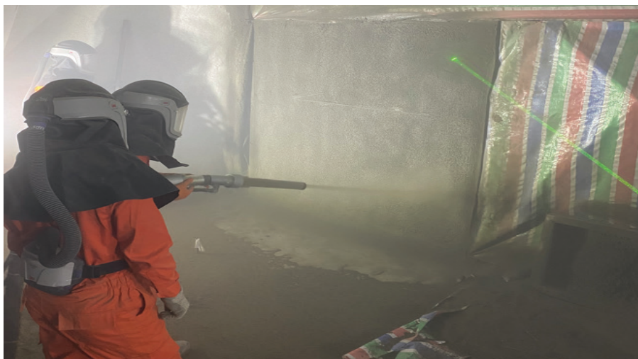
Bê tông phun cường độ siêu cao tại dự án đập Sauveterre (Pháp).
