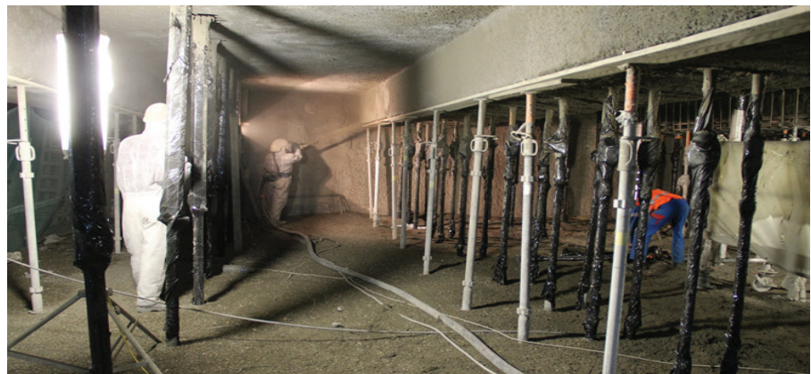
Sửa chữa khôi phục kết cấu bằng bê tông phun sau sự cố do hỏa hoạn.
