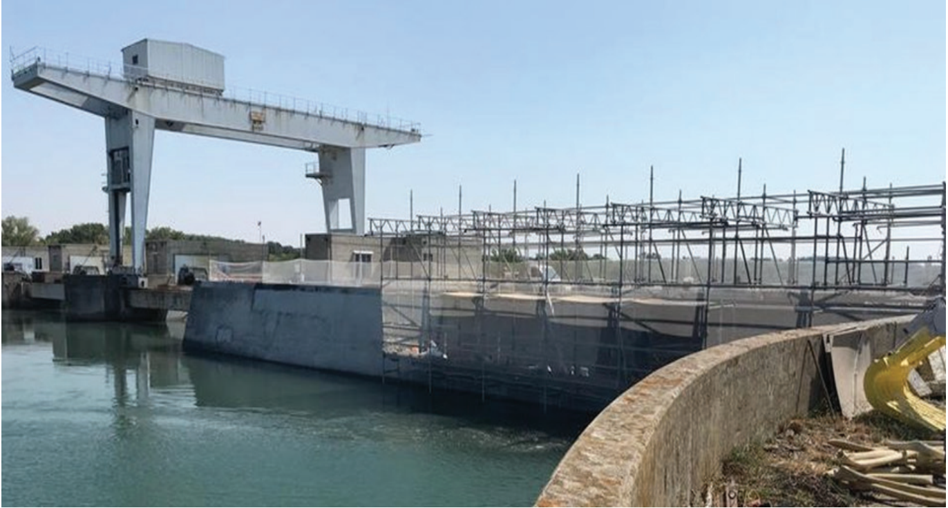
Thi công bê tông phun cường độ siêu cao 85 Mpa do Freyssinet Việt Nam thực hiện tại Nam Theun 2 (Lào).
