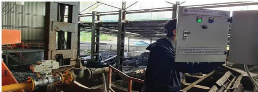
Bộ thu thập, điều khiển lưu lượng khí và hệ thống điều khiển tự động được lắp đặt trên thiết bị Tankcell.
