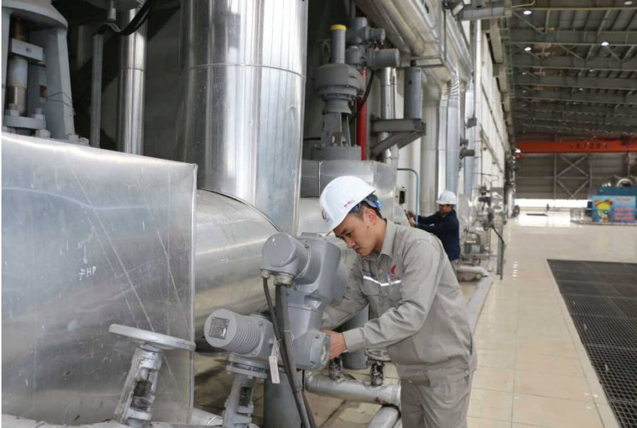
Kỹ sư Phòng Điều khiển Trung tâm (Công ty Nhiệt điện Đông Triều) vận hành, kiểm tra các thiết bị trong nhà máy.
