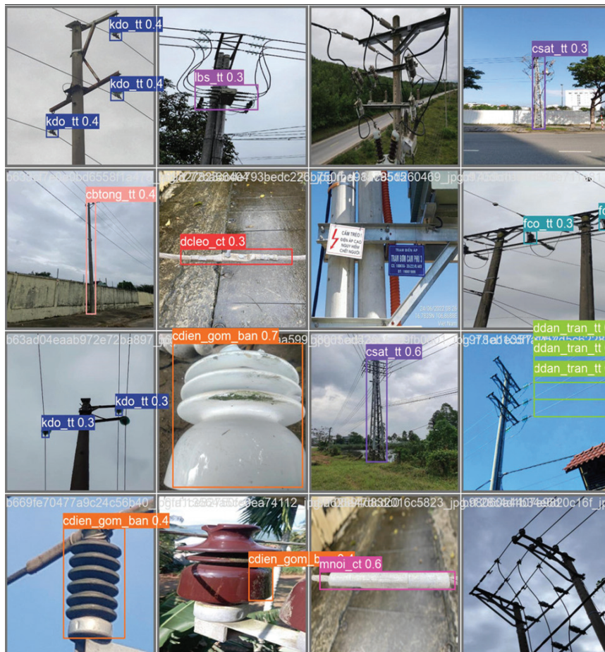
Hình 2. Hình ảnh mất an toàn lưới điện được drone/UAV phát hiện.
