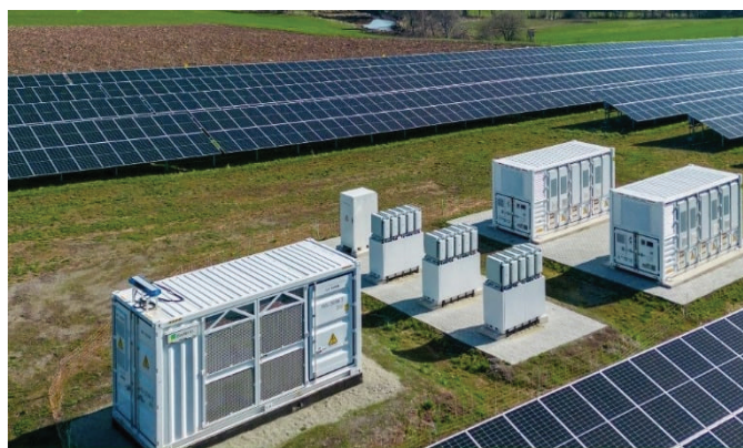
Nhà máy điện lưu trữ kết hợp với pin mặt trời và quang điện ở Spitalhofe, Đức. Ảnh: ST.
