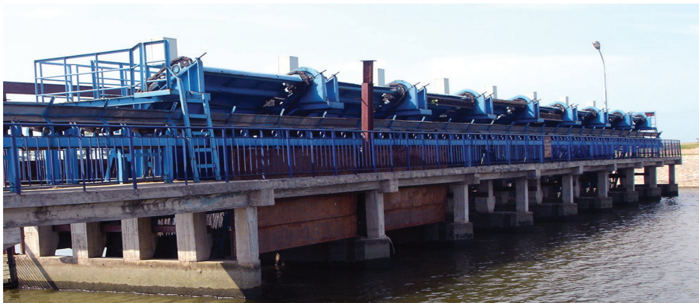
Sản phẩm thiết bị vớt rác tự động của Viện Khoa học Thủy lợi Việt Nam lắp đặt tại Trạm bơm Vĩnh Trị 1, Nam Định.
