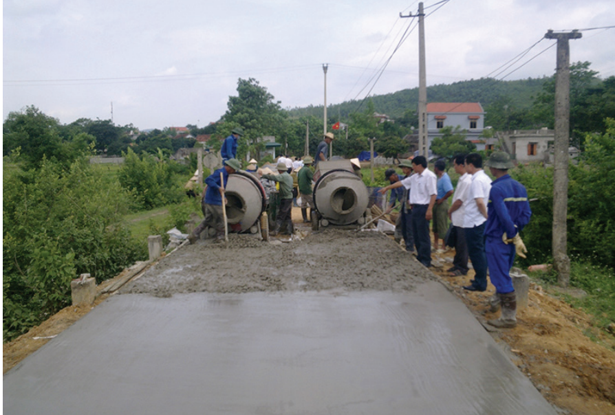
Người dân tham gia xây dựng giao thông ở xã nông thôn mới.
