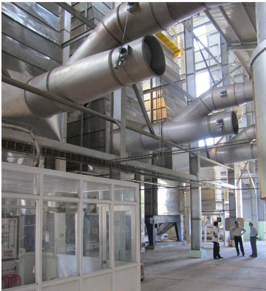
Hệ thống sấy lúa công nghiệp tại Công ty Lương thực Tiền Giang
