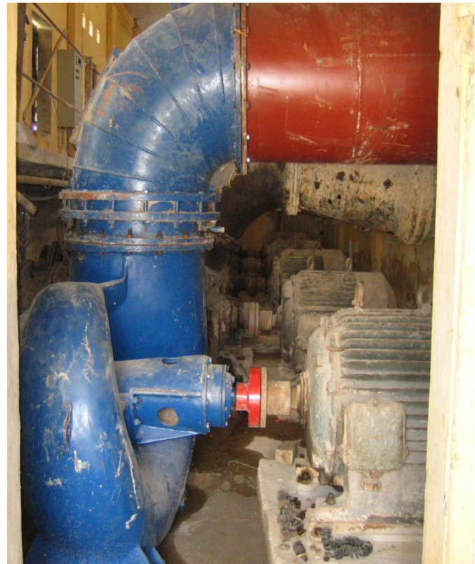
Trạm bơm sử dụng bơm HT3600-5
