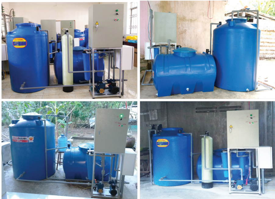
Hệ thống xử lý nước sinh hoạt ứng dụng công nghệ plasma lạnh quy mô hộ gia đình.
