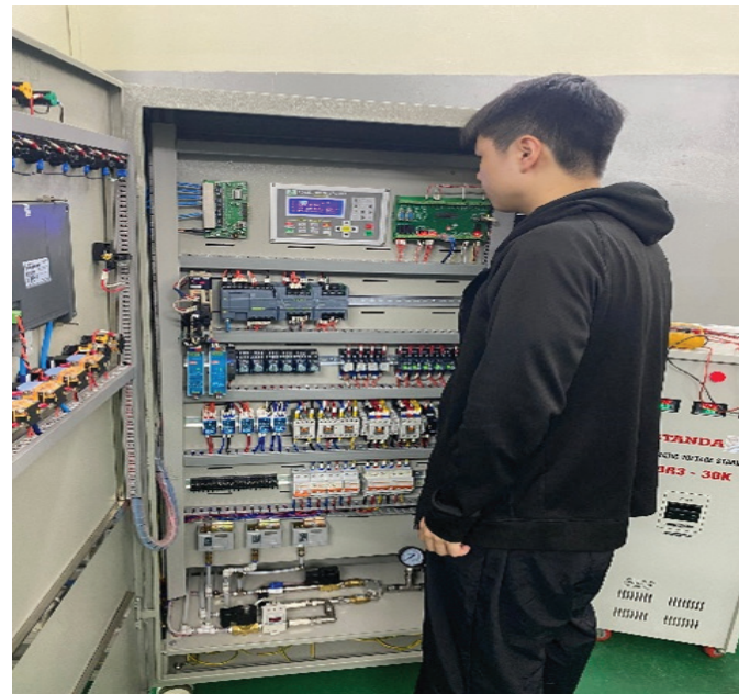
Lắp ráp và tủ điều khiển tổng thể thiết bị. Ảnh: NACENTECH.
